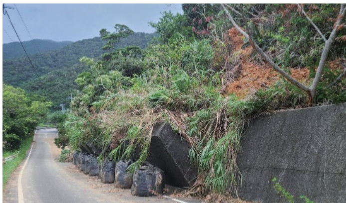
図2 道路側に倒壊した擁壁
